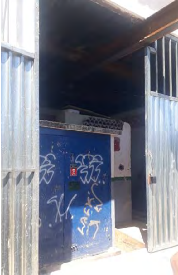
Foto 3 - EEA (Estação Elevatória de Água).
