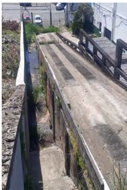
Foto 12 - Esgoto na Área do Museu do Samba
