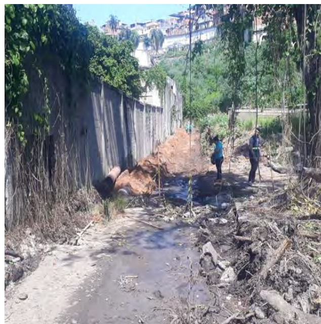
Foto 8 - Esgoto a céu aberto – Antigo IBGE
