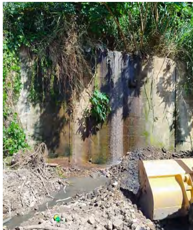
Foto 7 - Esgoto proveniente da comunidade
