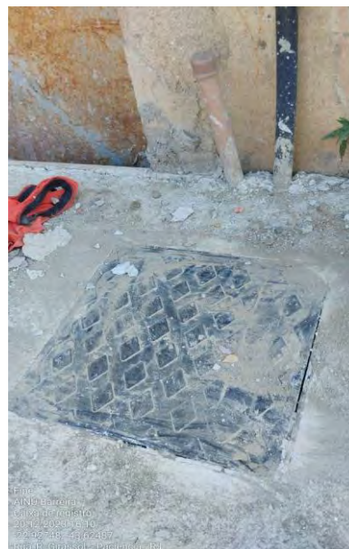
Foto 12 – Caixa de registro e tubo PVC
