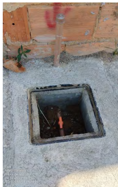
Foto 13 – Registro em PVC
