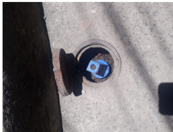
Foto 15 - Registro de piso – manutenção e manobra
