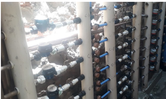
Foto 13 - "Totem" no interior da Comunidade com os Medidores Instalados
