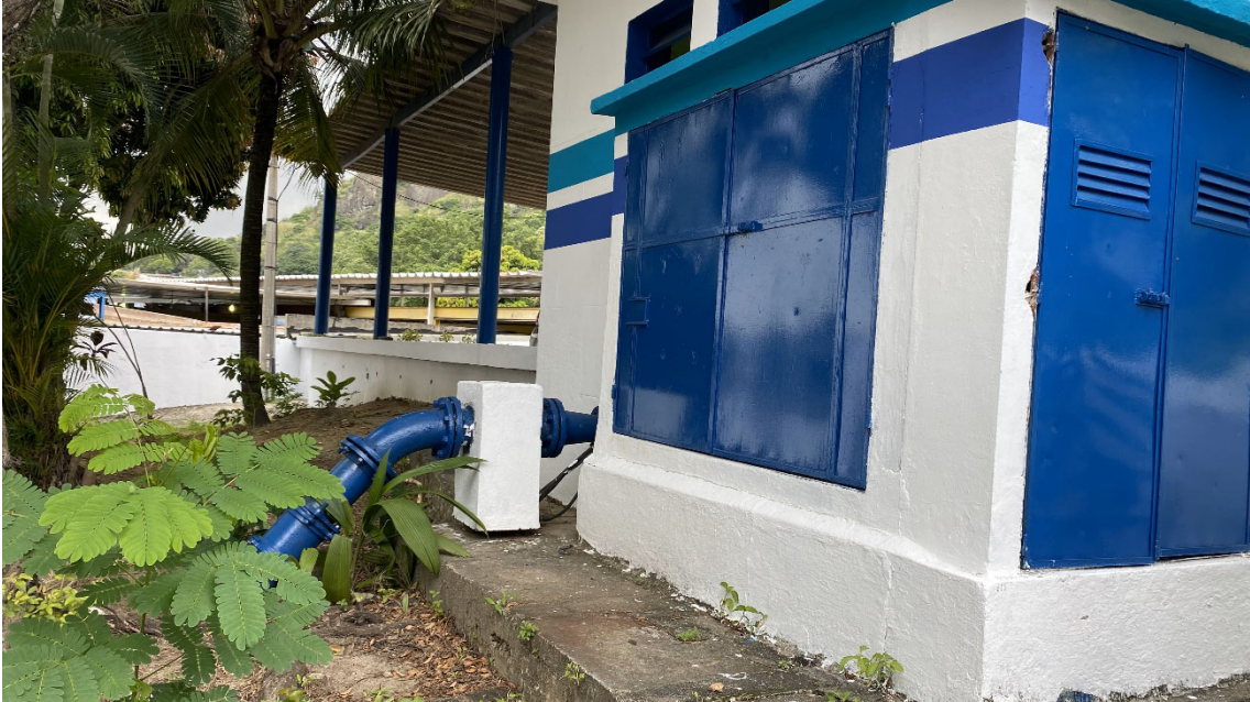
Foto 18 - Casa de Bombas
