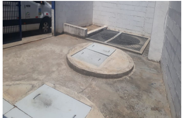
Foto 8 - EEE (Estação Elevatória de Esgoto)
