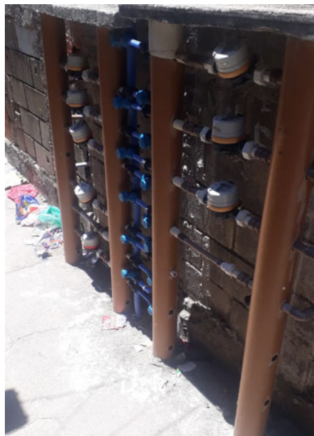
Foto 14 - "Totem" no interior da Comunidade com os Medidores Instalados
