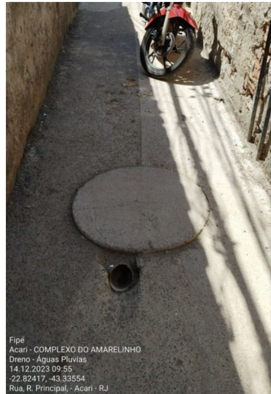
Foto 2 - Poço de Visita - Rede de esgoto - Acari
