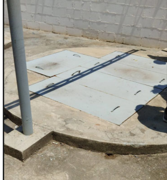
Foto 7 - Poço das bombas de recalque
