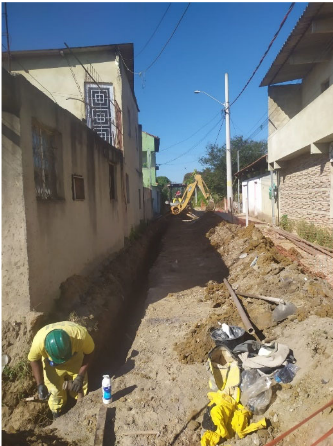
Foto 3: Obra de lançamento da rede de água potável sendo realizada na Rua Girassóis.
