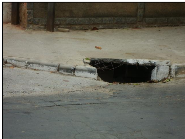
Figura 35 – Boca de lobo em péssimo estado de conservação 4
