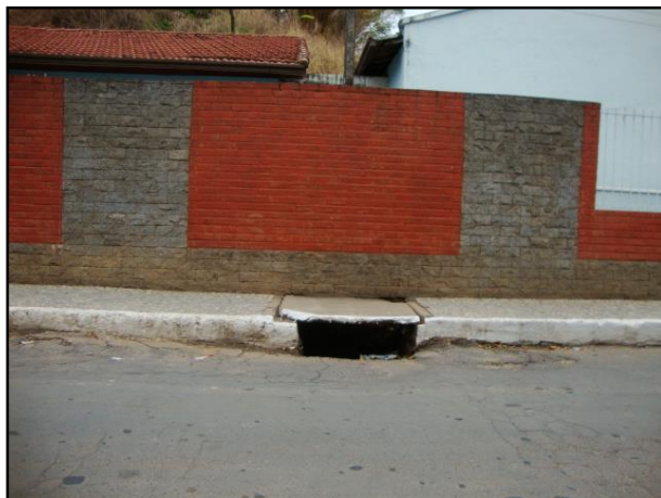
Figura 34 – Boca de lobo em péssimo estado de conservação 3
