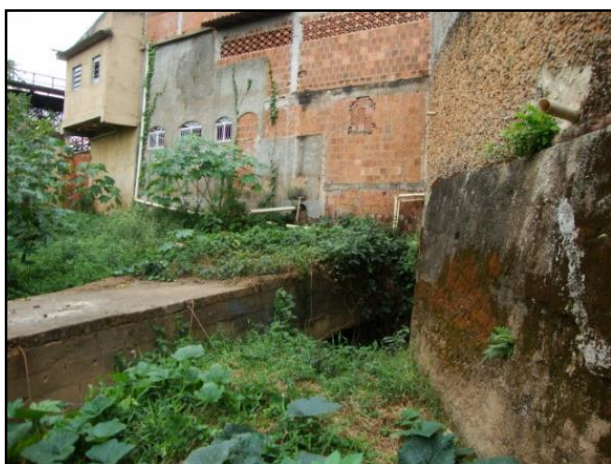
Figura 27 - Saída de rede de esgoto e pluvial na margem do Rio Paraíba do Sul
