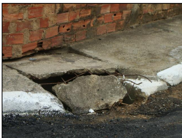
Figura 32 – Boca de lobo em péssimo estado de conservação 1
