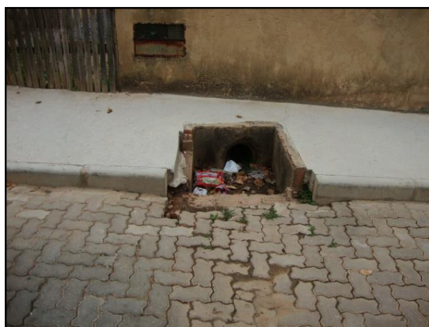
Figura 33 – Boca de lobo em péssimo estado de conservação 2
