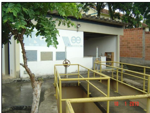
Figura 10 – Estação Elevatória de Água Bruta
