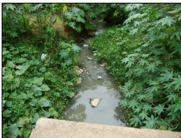
Figura 26 - Lançamento de esgoto e águas pluviais no Rio Paraíba do Sul do Bairro Ponte Preta
