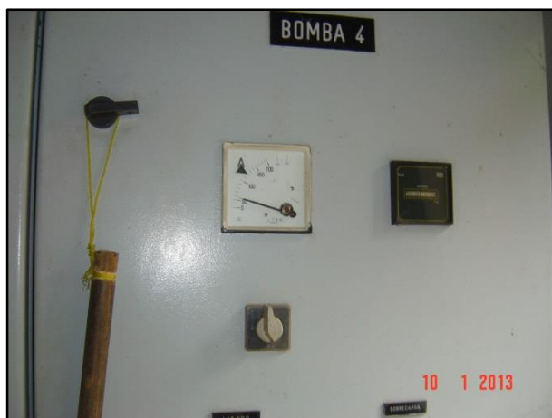
Figura 13 – Painel de forçada EEAB
