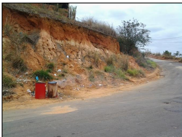
Figura 30 – Rua com carreamento de solo pela falta de drenagem
