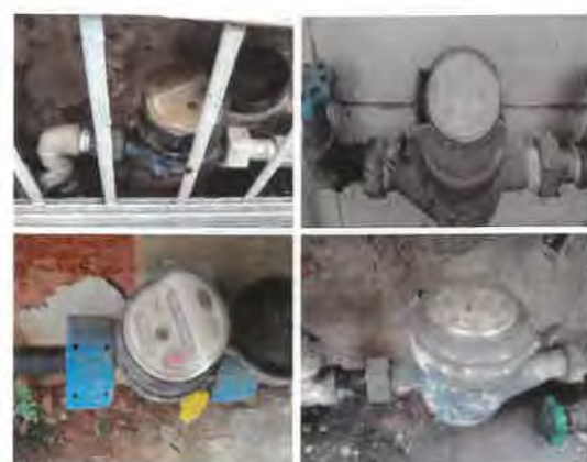
FIGURA 1.88 – HIDRÔMETROS FORA DA VIDA ÚTIL.
