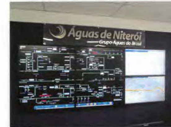
FIGURA 1.59 – EXEMPLO DE MODELO DE CCO DE ÁGUA A SER IMPLANTADO EM PARAÍBA DO SUL. ESTE CCO FOI IMPLANTADO NA ÁGUAS DE NITERÓI, UMA DAS CONCESSIONÁRIAS DO GRUPO ÁGUAS DO BRASIL
