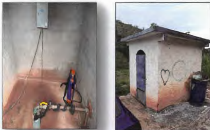
FIGURA 1.25 – POÇO 02 - CAPTAÇÃO SUBTERRÂNEA 2 – DISTRITO INCONFIDENCIA
