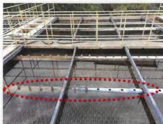
FIGURA 1.41 – TUBOS PERFORADOS DE COLETA DE ÁGUA DECANTADA DESNIVELADOS
