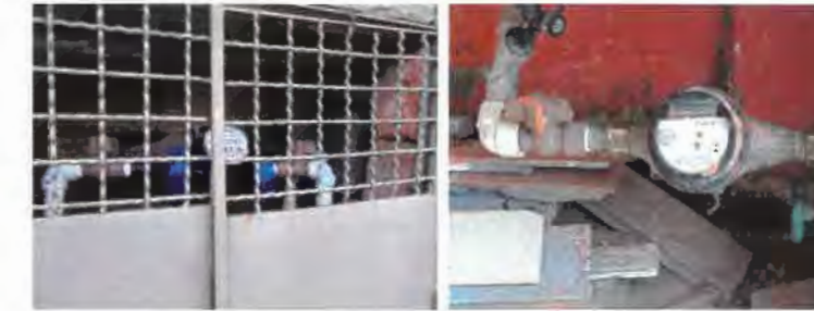
FIGURA 1.105 – HIDRÔMETROS INSTALADOS INCLINADOS
