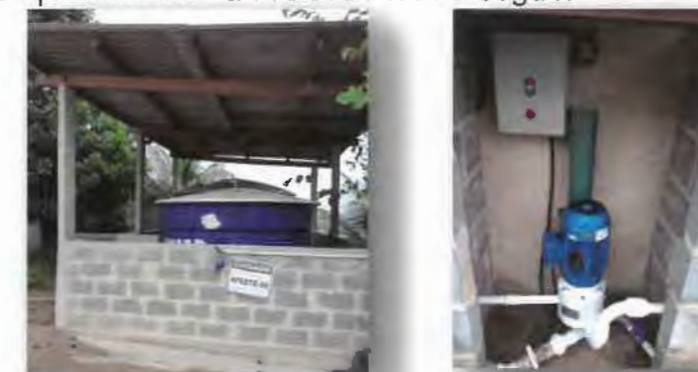
FIGURA 1.44 – TANQUE DE ARMAZENAMENTO DE PAC E BOMBA DOSADORA
