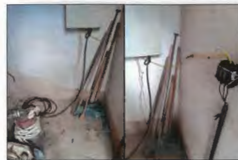
FIGURA 1.23 – POÇO 01 - INSTALAÇÕES ELÉTRICAS DO QUADRO DE COMANDO – DISTRITO INCONFIDÊNCIA
