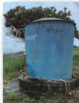
FIGURA 1.66 – RESERVATÓRIO BREJAL - SISTEMA SALUTARIS VERANEIO (BREJAL)
