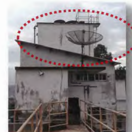
FIGURA 1.43 – RESERVATÓRIO DE ÁGUA DE LAVAGEM PARA OS FILTROS
