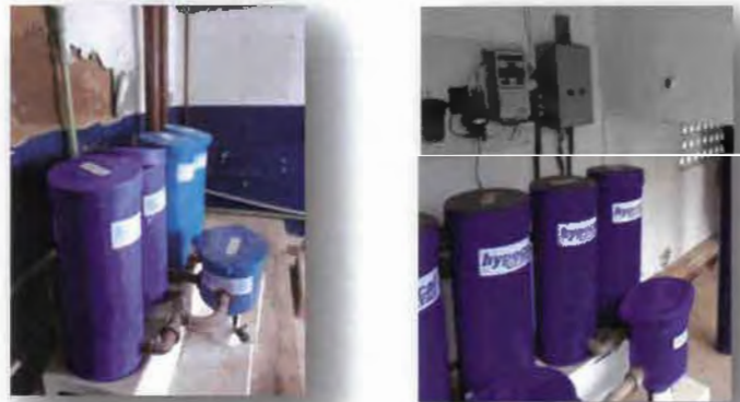
FIGURA 1.45 – SISTEMA DE DOSAGEM DE HIPOCLORITO DE CÁLCIO (A DIREITA AINDA FORA DE OPERAÇÃO)
