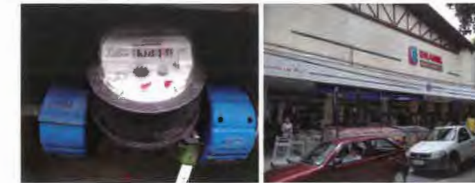
FIGURA 1.111 – HIDRÔMETRO DE UM SUPERMERCADO COM DIMENSIONAMENTO INCORRETO
