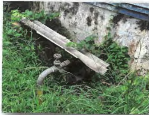
FIGURA 1.74 – BOOSTER LIMOEIRO - SISTEMA PRINCIPAL
