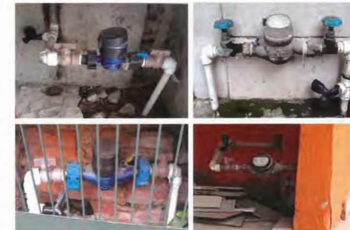
FIGURA 1.112 – CAVALETE COM TORNEIRA INSTALADA
