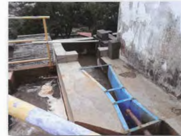
FIGURA 1.36 – CANAL DE ENTRADA, CALHA PARSHALL E DOSAGEM DE COAGULANTE NA ÁGUA BRUTA
