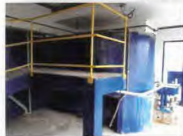
FIGURA 1.46 – TANQUES DE SOLUÇÃO DE CAL HIDRATADA
