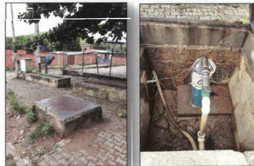
FIGURÁ 1.21 – CAPTAÇÃO SUBTERRÂNEA –SALUTARIS VERANEIO (BREJAL)
