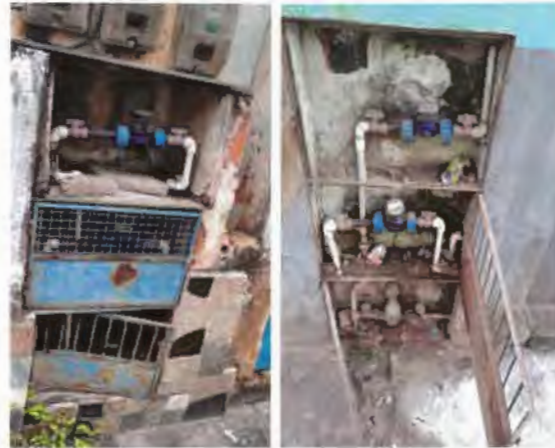
FIGURA 1.103 – CAVALETES CONSTRUÍDOS DE FORMA INADEQUADA
