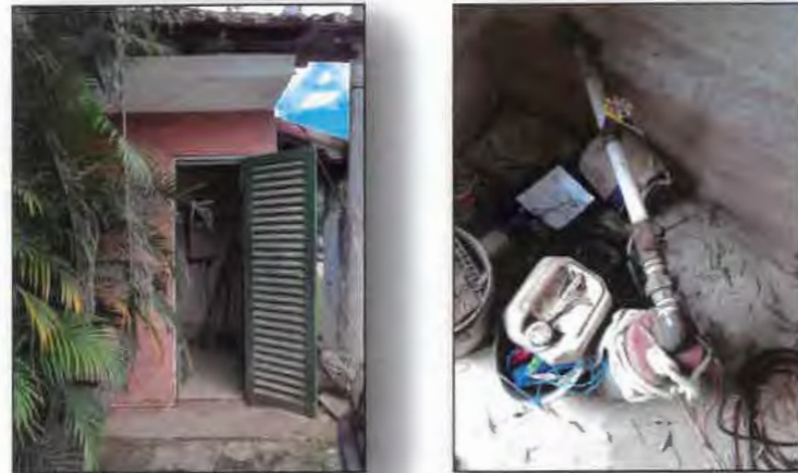
FIGURA 1.22 – POÇO 01 - CAPTAÇÃO SUBTERRÂNEA – DISTRITO INCONFIDÊNCIA
