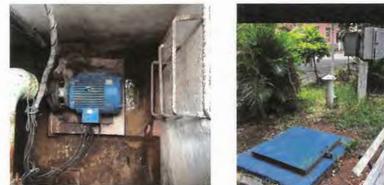
FIGURA 1.72 – EEAT LIMOEIRO - SISTEMA PRINCIPAL
