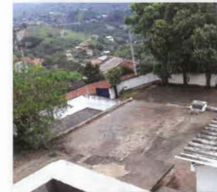
FIGURA 1.47 – RESERVATÓRIO DE ÁGUA TRATADA
